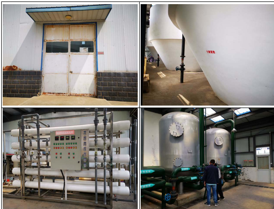
图 6-3-3 矿井水处理站实景图
