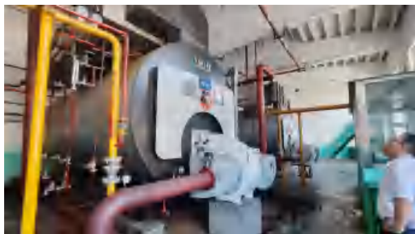
燃气锅炉（已配备低氮措施）
